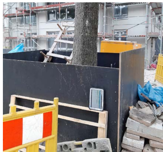
Stammschutz ohne Schutz des Wurzelbereichs
